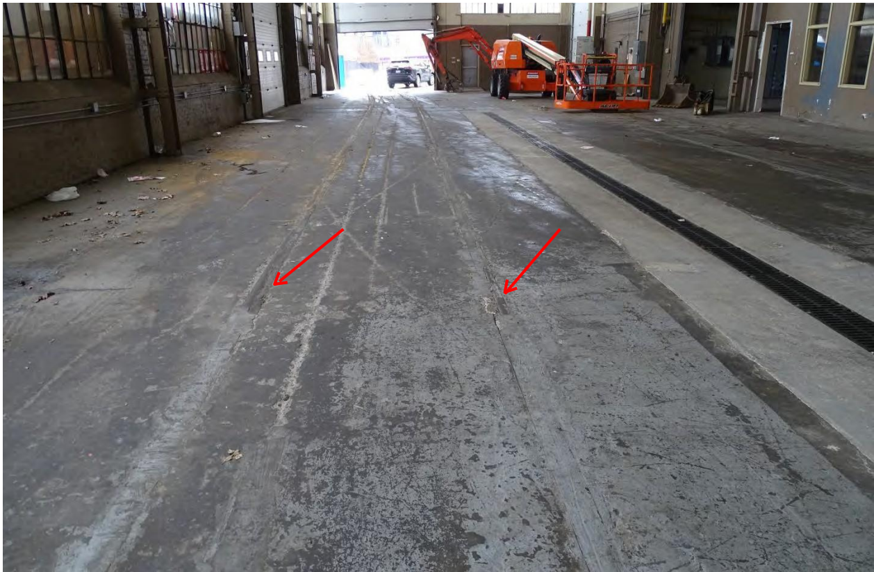
Figure 77 : Atelier d'usinage de 1935 montrant les voies ferrées encastrées dans la dalle. Crédit : SBA, février 2021.
