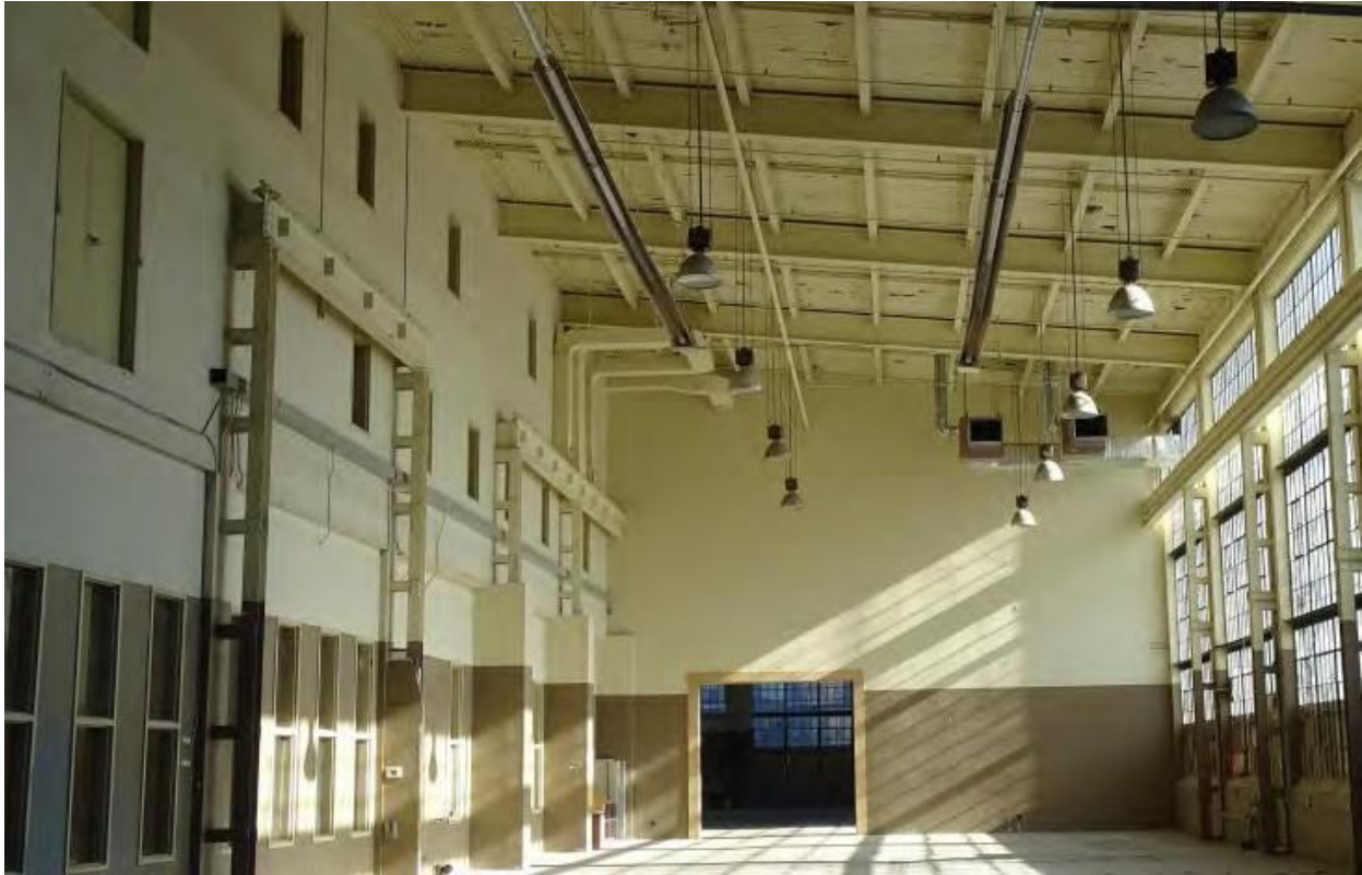
Figure 75 : Atelier d'usinage de 1935 montrant la structure des équipements sur les murs nord et sud. Crédit : SBA, novembre 2020.
